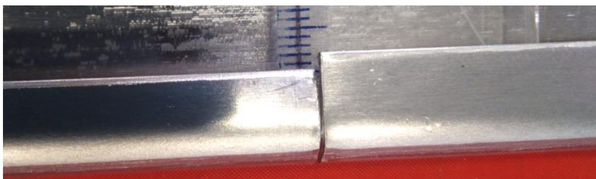
Fot 1. Wywinięcie blachy.,
